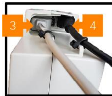
Batterie de secours Connecteurs
