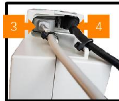
Batterie de secours
